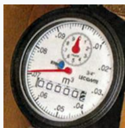
Compteur en mètres cubes (m 3 )
